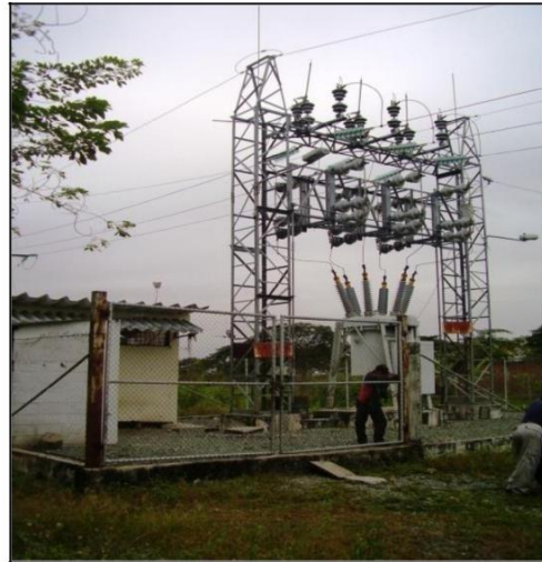
Subestación Eléctrica “Magro”
